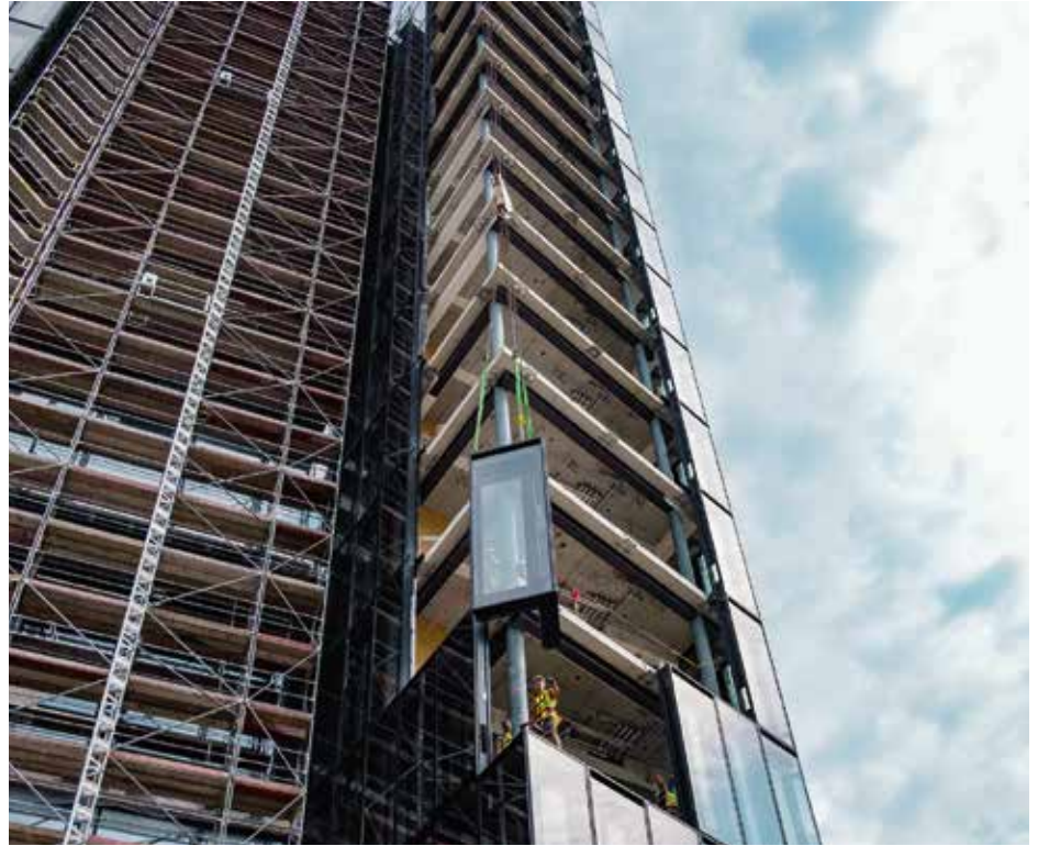
Die Bitzer Firmenzentrale in Sindelfingen: auf 70 m Höhe ausgerüstet mit Trinkwasser-Rohrleitungssystemen von Viega.
