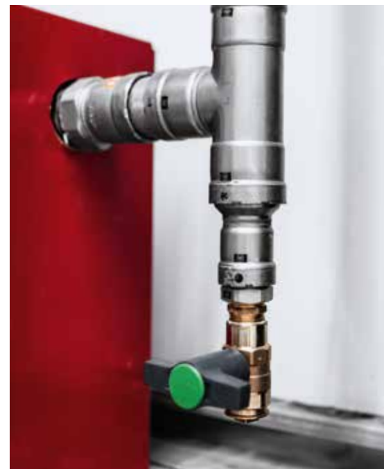
Normgerecht: eine Feuerlöschanlage mit Viega Pressverbindern.
