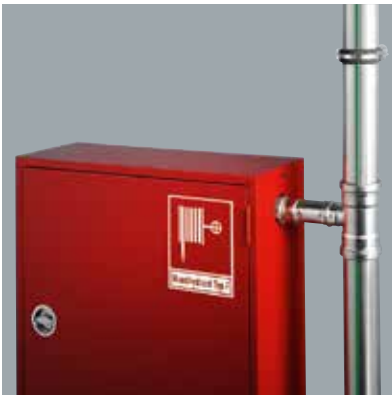
Abb. 7 – 26 Wandhydrant Typ F
