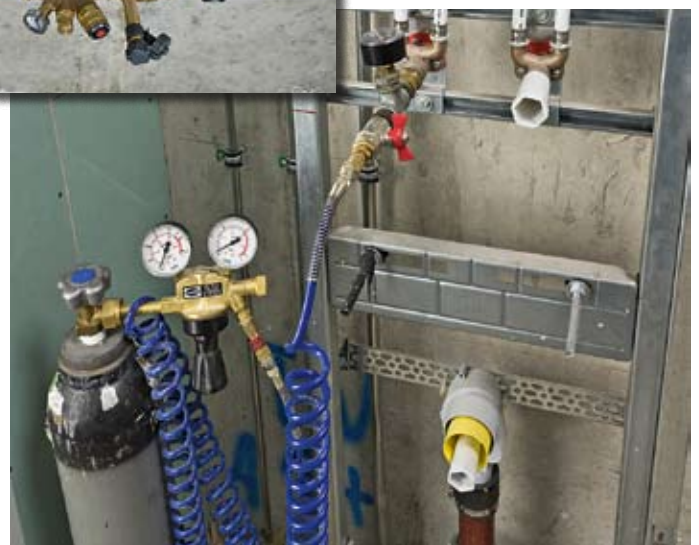
■ In größeren Gebäuden gilt eine fachgerechte Dichtheitsprüfung mit ölfreier Druckluft oder wie hier mit Inertgas seit Jahren als anerkannte Regel der Technik.
