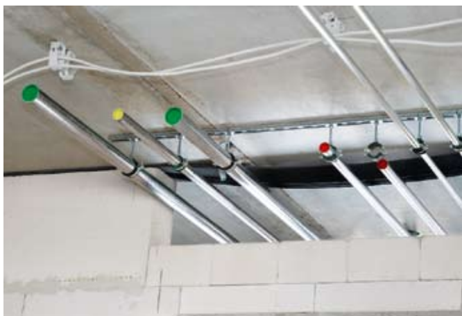
Trinkwasserhygiene schon im Rohbau: Jedes Rohrende wird selbstverständlich mit einem Stopfen gegen eindringenden Schmutz abgesichert.
